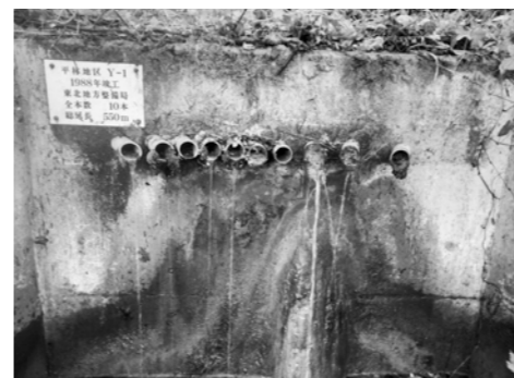
配管が詰まっている箇所
