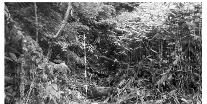
倒木により水路が埋没している箇所
