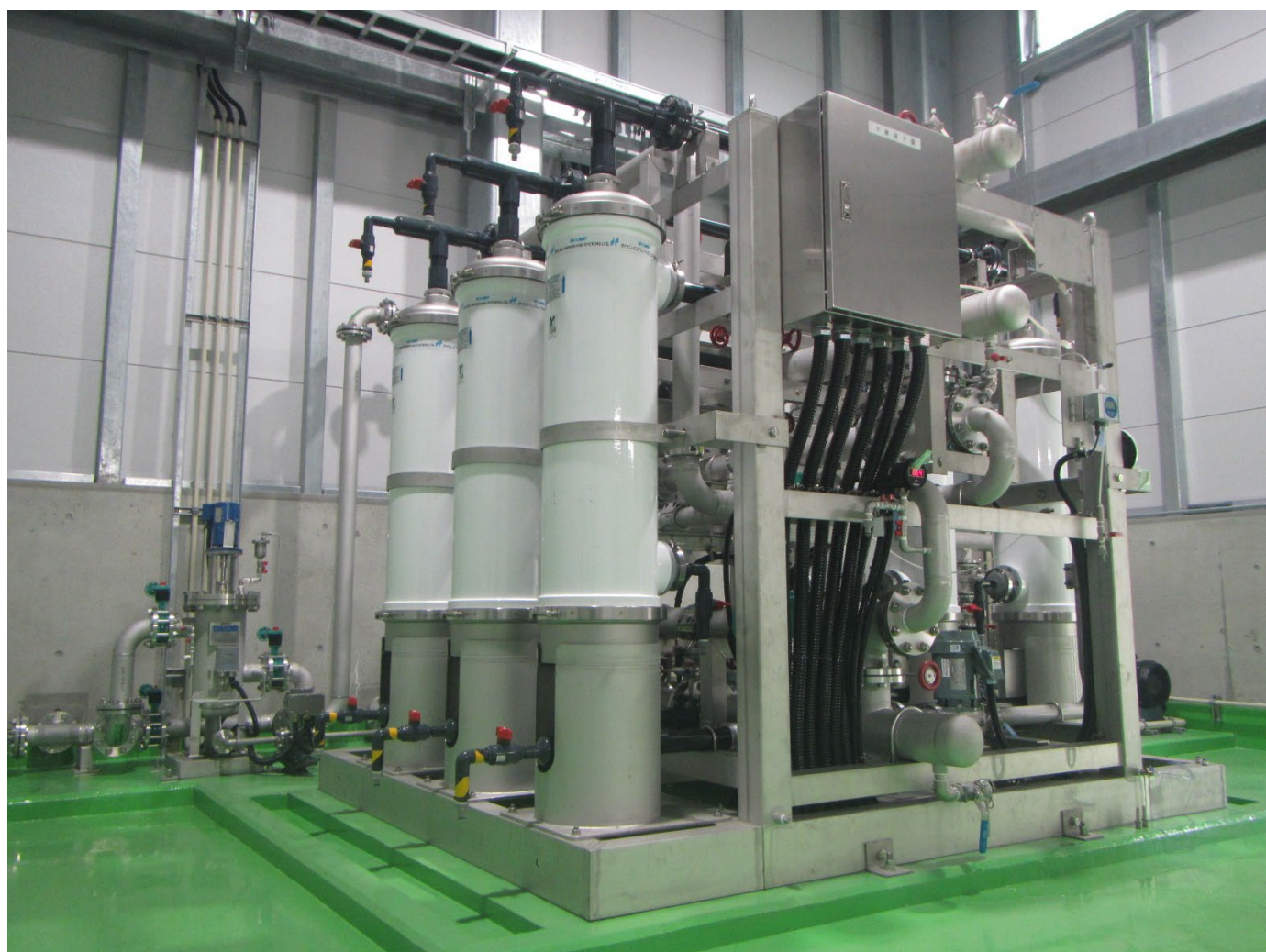
【写真：令和2年11月に給水を開始した新肘折浄水場膜ろ過装置】
