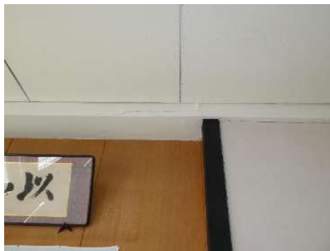
内壁のクラック
