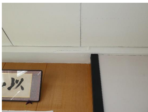
内壁のクラック
